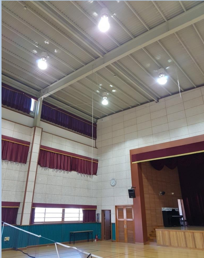
지붕 스페이스프레임 부재 파손
