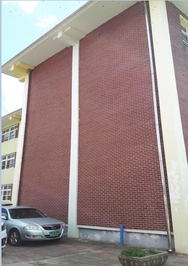
외벽 치장벽돌 균열 및 변형
