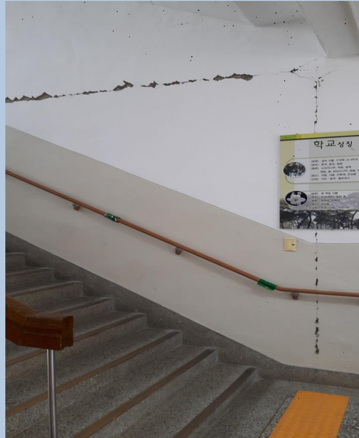
철근 콘크리트조와 조적조 기움벽 균열
