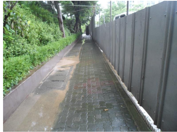
가설울타리 외부(하부 마감 누락)
