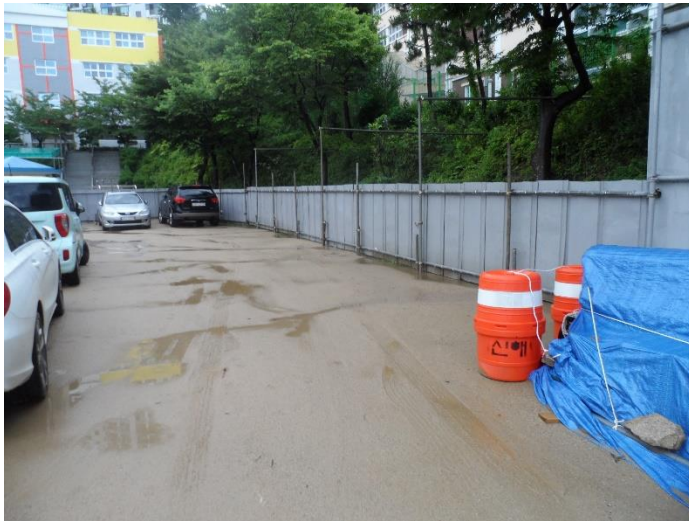
가설울타리 내부(하부 마감 누락)
