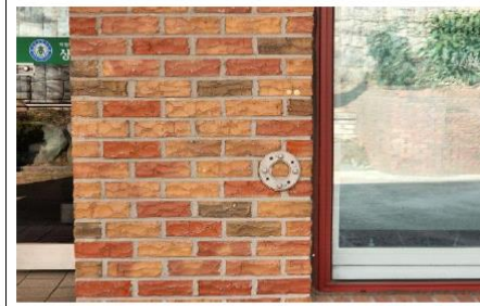
건물 경사계 설치 사례
