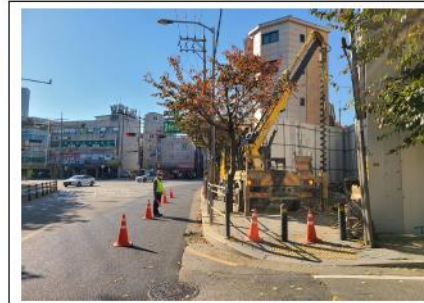
통학로 점유구간 라바콘 설치 사례
