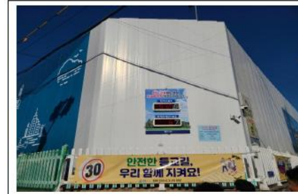
가설방음벽 및 소음측정기 설치 사례
