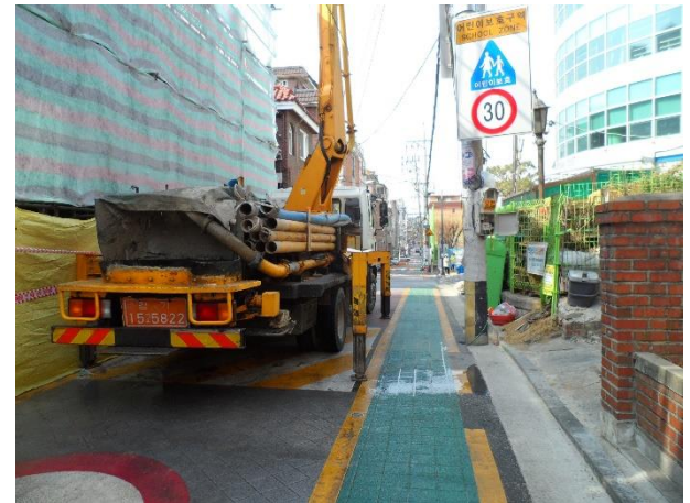
통학로 콘크리트 타설 미흡
