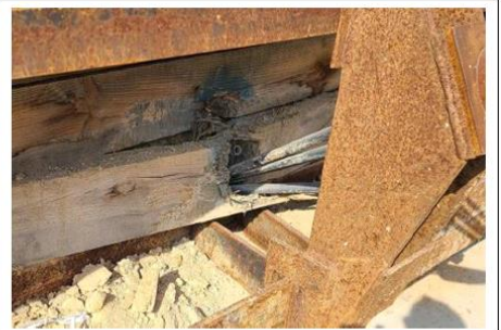
흙막이(토류판) 파손 사례
