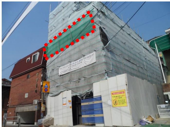
낙하물 방지망 설치 미흡
