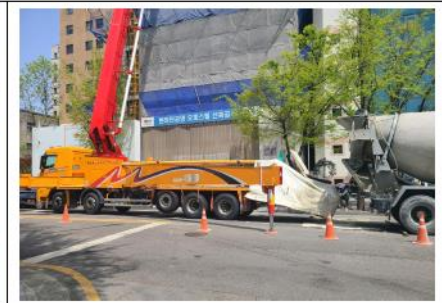
통학로 점유구간 라바콘 설치 사례
