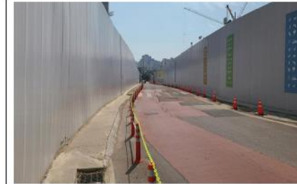
차선규제봉, 라바콘 설치 사례
