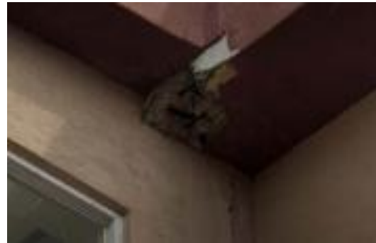
노출 콘크리트 탈락
