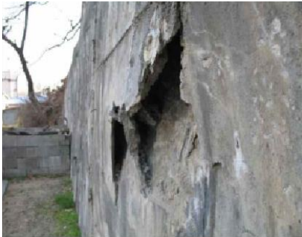
옹벽의 균열 또는 파손
