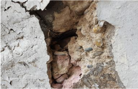
기둥 콘크리트 탈락(철근 부식)
