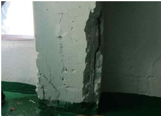
기둥 콘크리트 박락 및 철근 노출
