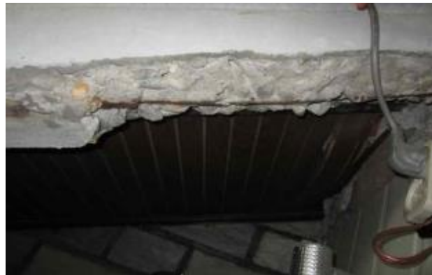
보 하부 콘크리트 탈락 및 철근 노출
