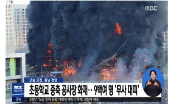
공사장 용접불꽃 화재 발생
