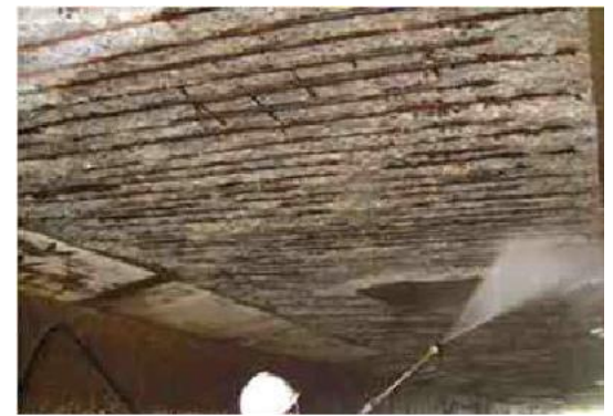
시설물의 철근콘크리트의 염해(鹽害) 또는 탄산화에 따른 내력 손실
