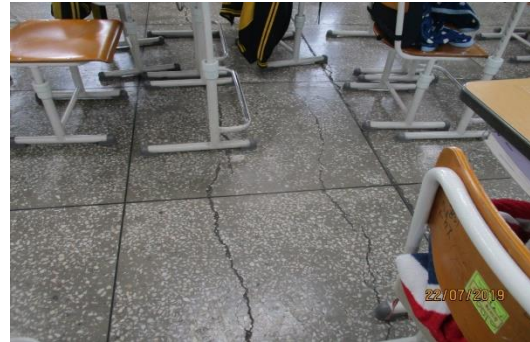
바닥 콘크리트 균열
