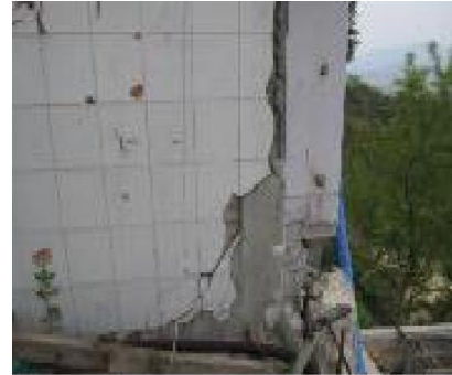
지반침하 및 이로 인한 활동적인 균열
