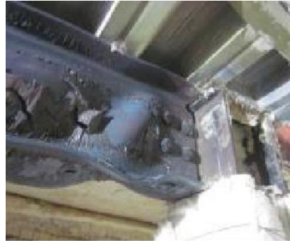
주요 구조부재의 변형 및 균열의 심화
