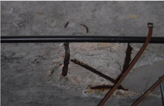
스라브 콘크리트 탈락(철근 부식)
